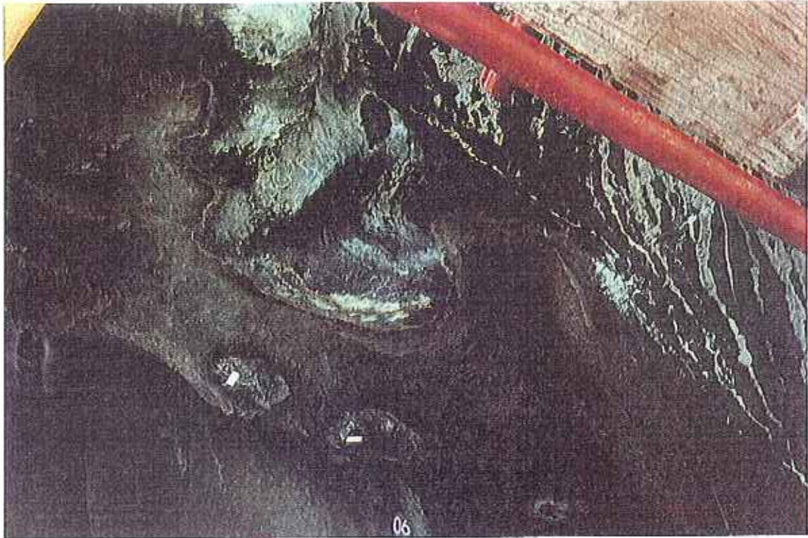
fig.8 - Estátua do Marquês de Pombal. Zona da barriga do leão. Patina verde sobre a patina preta, no centro, acumulação de produtos cinzentos pulverulentos.
