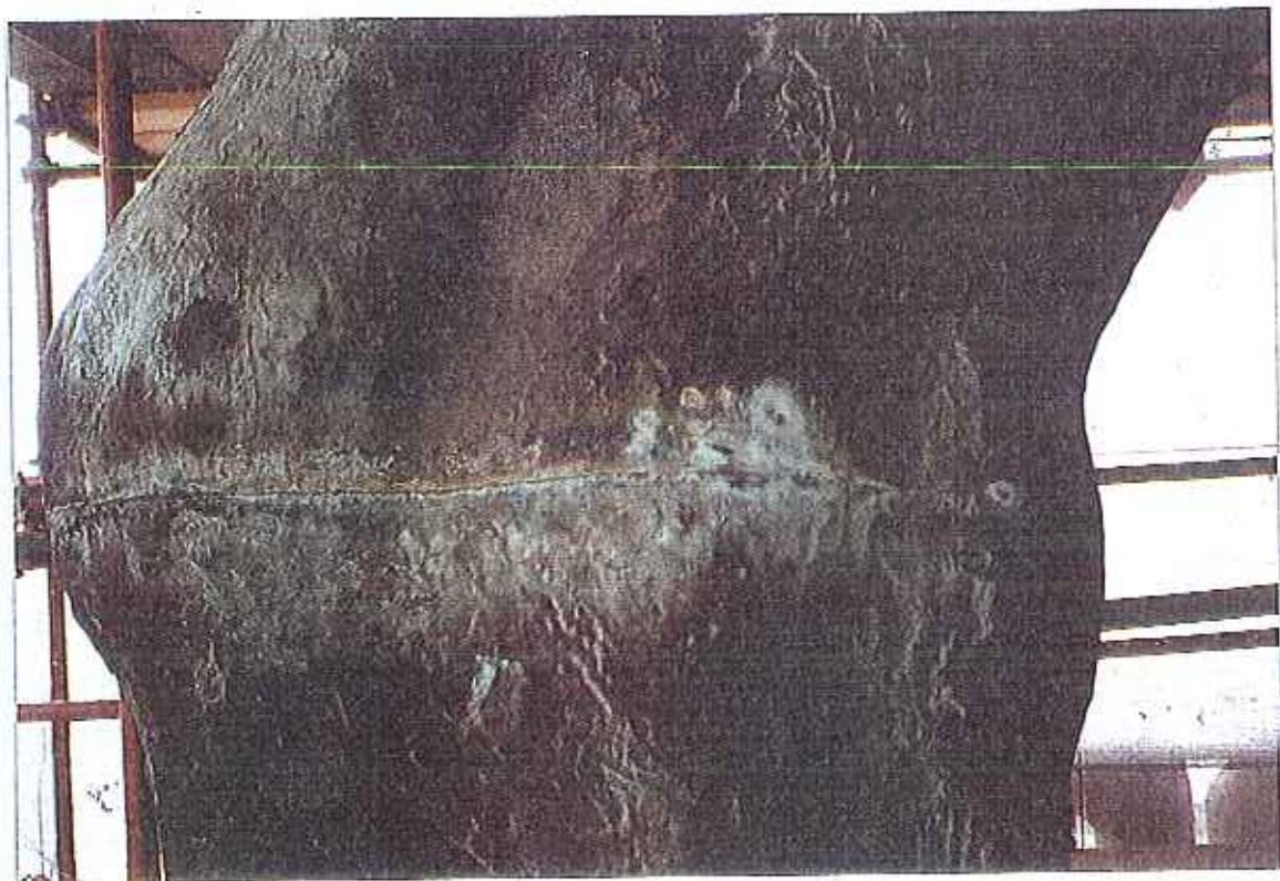
fig.11 - Estátua do Marquês de Pombal. Manchas verdes localizadas ao longo de uma junta.
